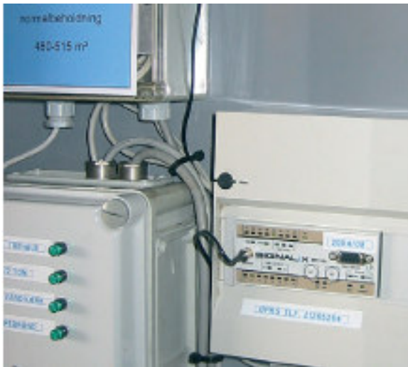
Signalix MT-101 telemetry module installed in Asnæs Vandværk
